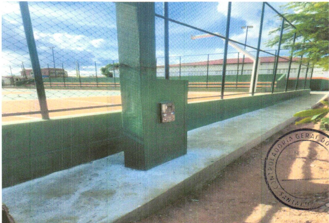
FOTO 14- EXECUÇÃO DO PADRÃO DE ENERGIA COM OS DISJUNTORES.
